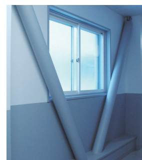
耐震補強の制震ブレース。校舎全体に設置。
